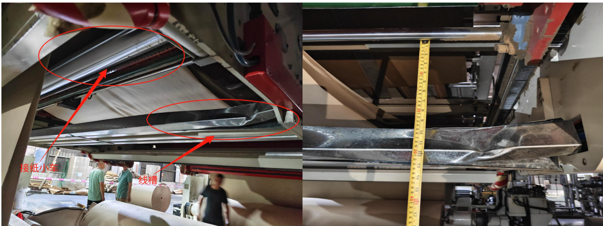
图 6：接纸车与设备线槽空隙约 20 厘米（末端弯曲变形）
