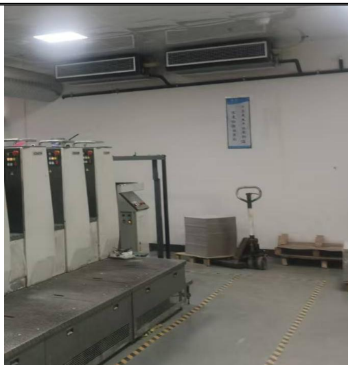
印刷废气收集设施情况
