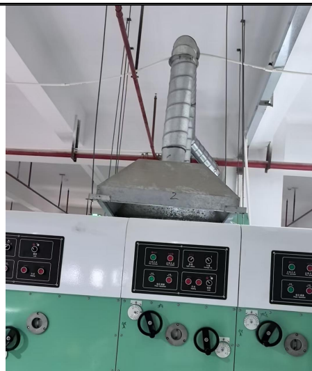
过油废气收集设施情况
