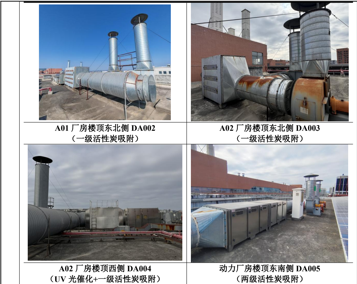
图 2-13 现有项目废气收集及处理设施情况照片
