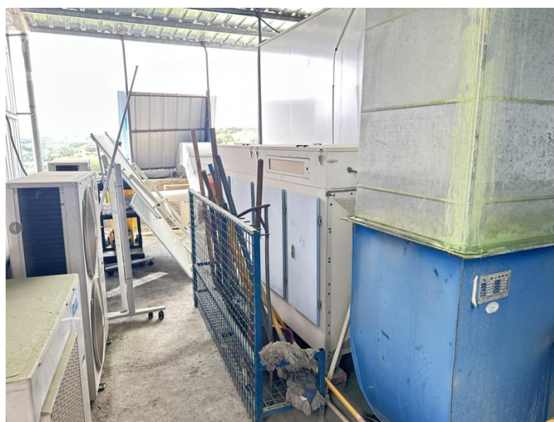
废气处理设施
