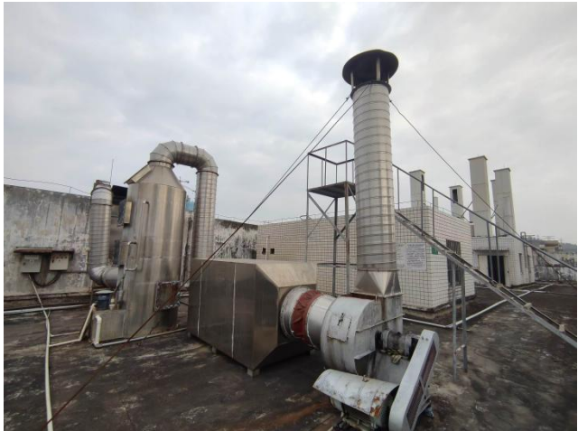
废气处理设施（DA003）
