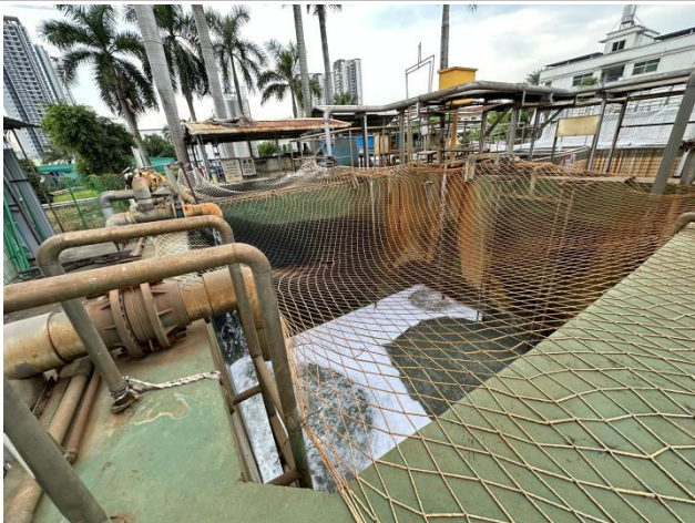
废水处理设施
