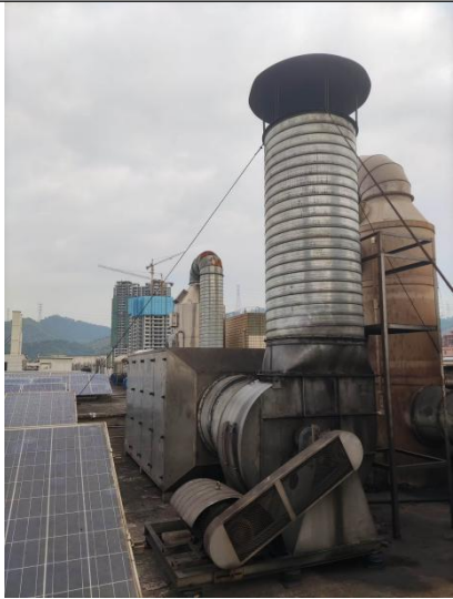
废气处理设施（DA002）
