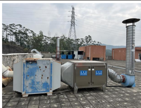
废气治理设施
