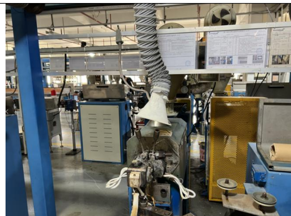
废气收集设施
