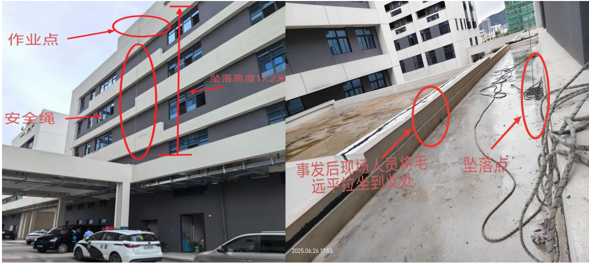
图 2：事发作业点及坠落点（坠落高度约 17.2 米）
