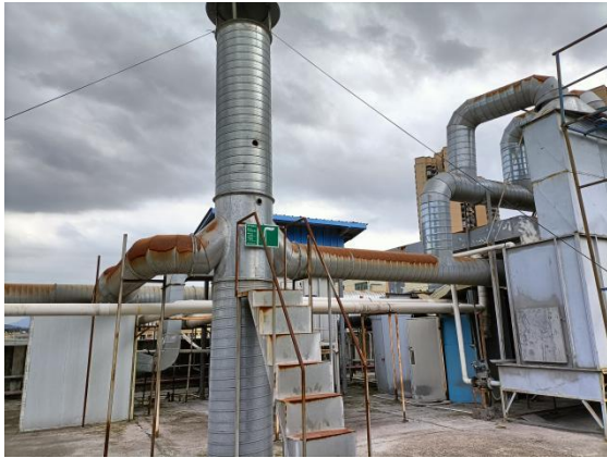
喷粉生产线废气处理设施及 DA004 排气筒
