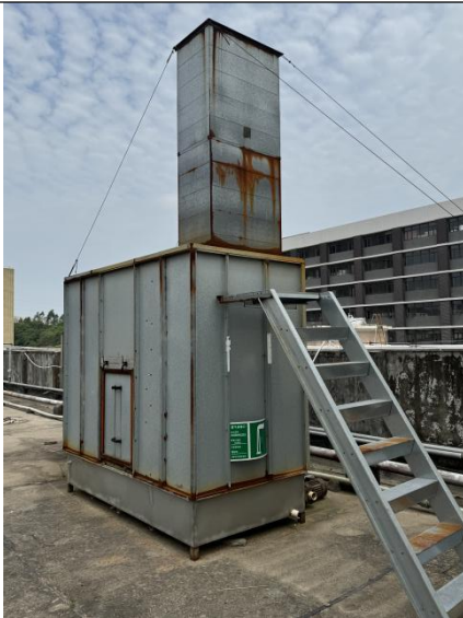
打磨废气排气筒 DA006
