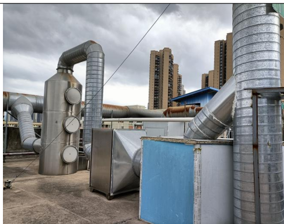
燃气烘烤废气处理措施及 DA005 排气筒
