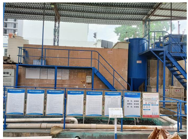
自建废水处理站
