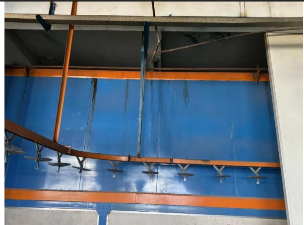
喷粉后固化和液化石油气燃烧废气收集措施(密闭抽风)
